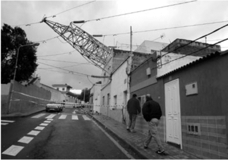
FOTO I. Caída de una torre del tendido eléctrico en una calle de Santa Cruz de Tenerife.
